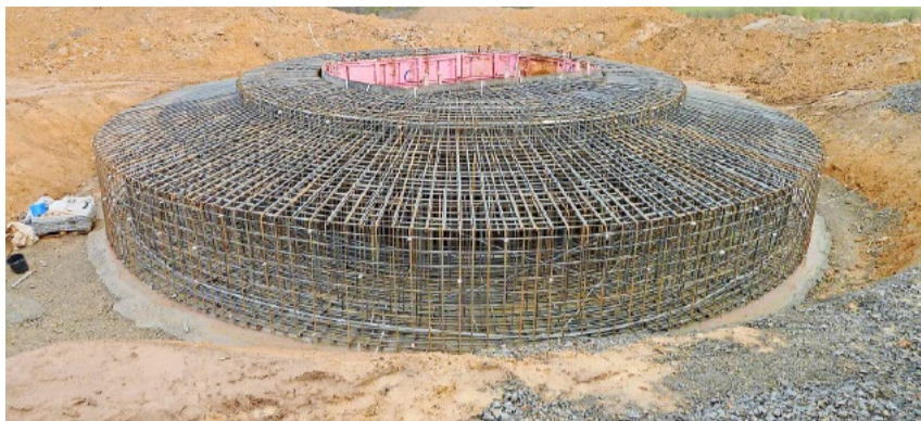
Bau eines Betonfundaments für ein Windrad. Die geplanten Windrad-Fundamente im Kanton Zürich werden etwa 1500 Tonnen wiegen. Bild: Wikipedia
