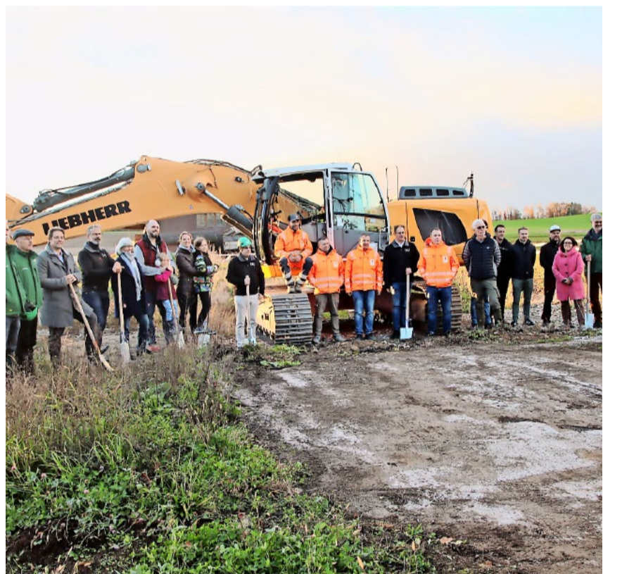
Alle beteiligten Handwerker, Bauherren sowie Gäste und erste Bewohner führen gemeinsam den Spatenstich aus. Bild: Roland Müller
